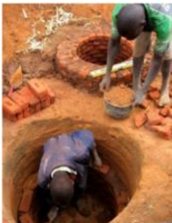
Renforcement des fosses avec des briques cuites (de simples briques moulées résistent peu aux pluies).
