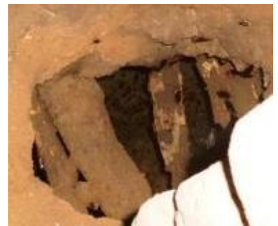
Dégradation de latrines par les termites
