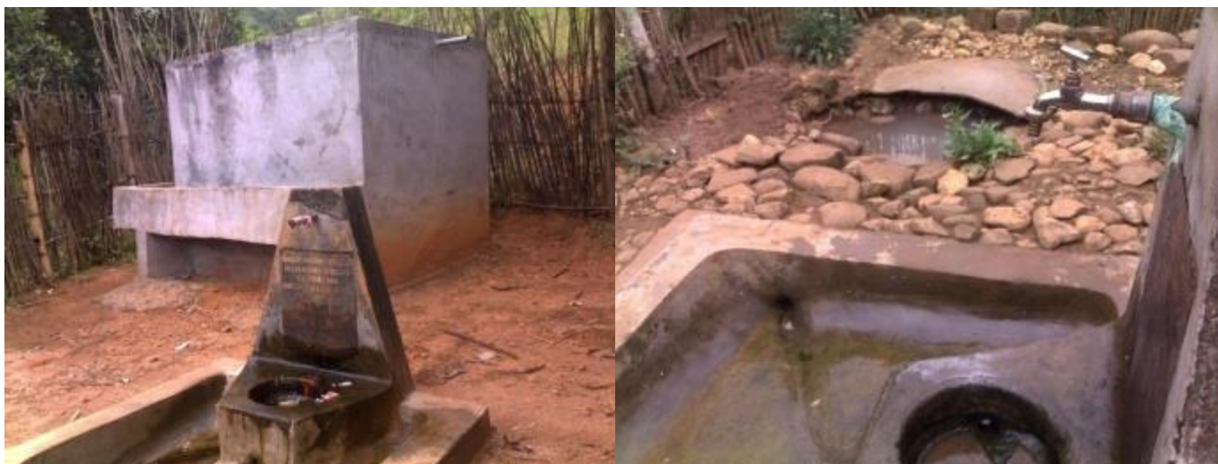
Figure 2: (Ambohimiarina) A gauche, BF non fonctionnelle. A droite, BF sans évacuation correcte des eaux usées.
