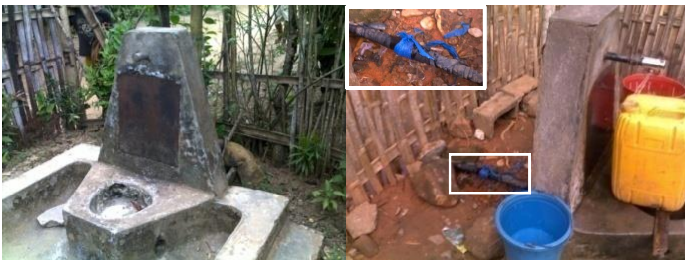
Figure 3: (Ambolitara) A gauche, BF non fonctionnelle. A droite, BF partiellement fonctionnelle avec mauvaise réparation de fuite.
