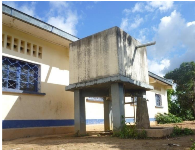
Figure 5 : Système de récupération d'eau de pluie à l'EPP du chef-lieu d'Andasibe (non fonctionnel).
