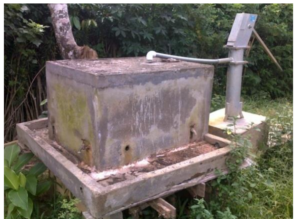
Figure 7 : Forage et système de lavage des mains installé dans l'EPP de Vohibinany (non fonctionnel).
