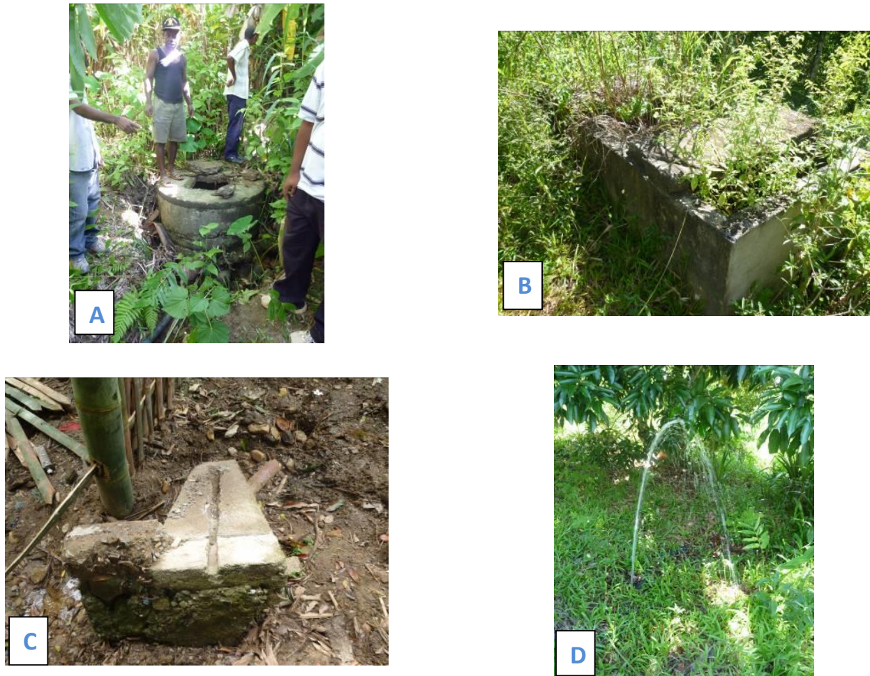
Figure 3: Photos des ouvrages du réseau de Bevato : captage de source (A), ouvrage de traitement (B), borne fontaine détruite (C), fuite sur la distribution (D).
