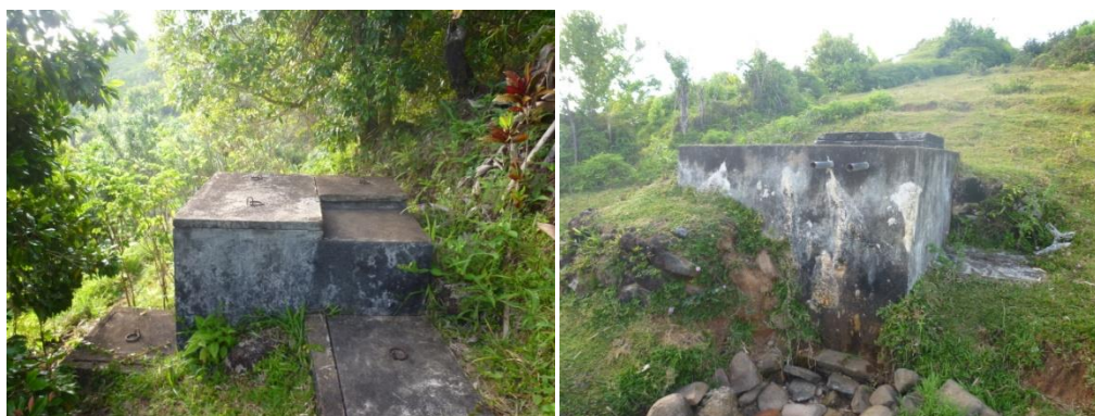
Figure 17: A gauche, le filtre à graviers - A droite, le réservoir de Sahaka.
