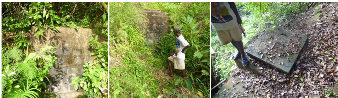
Figure 16: Les ouvrages de captage de Sahaka (2 boîtes de captage)
