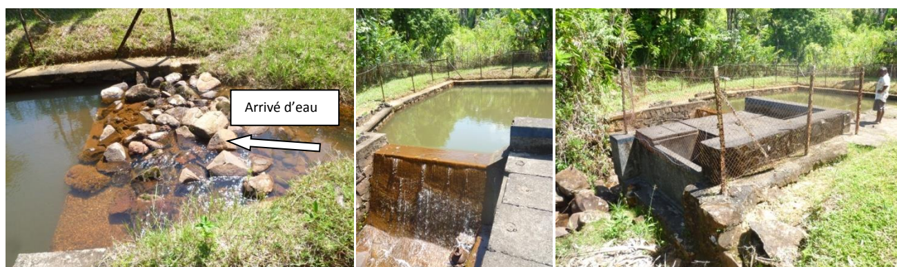
Figure 4: L'ouvrage de captage de Soanierana Ivongo (de gauche à droite: l'arrivée d'eau, le bassin)
