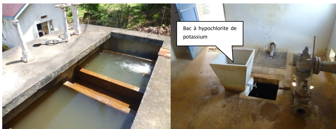
Figure 5: A gauche le filtre à sable, à droite le réservoir avec traitement à l'hypochlorite de potassium.
