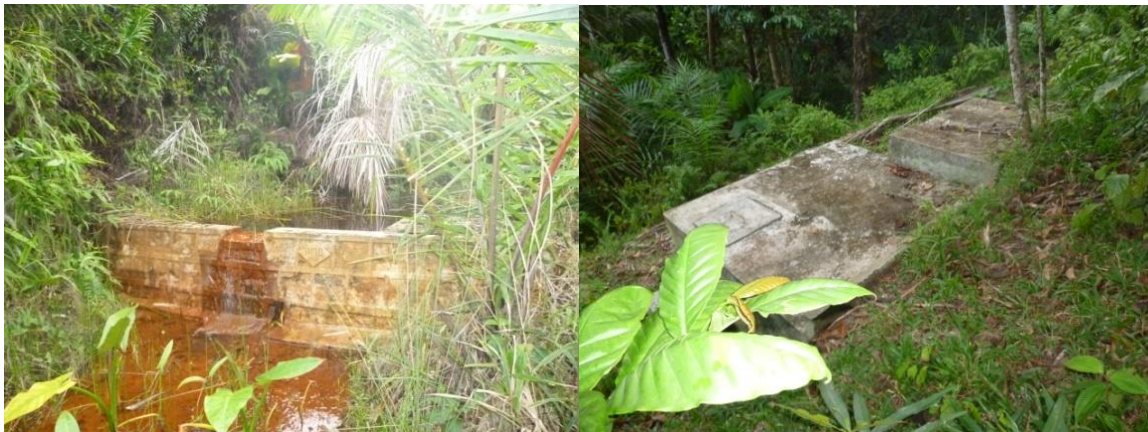
Figure 14: A gauche: Ouvrage de captage (barrage), à droite Citerne et filtre Manankinany
